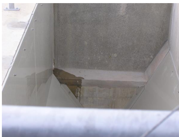
↑ První litry odpadní vody natékají do štěrbinové nádrže
