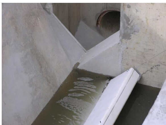
↑ Přepad z lapáku pisku do štěrbinové nádrže
